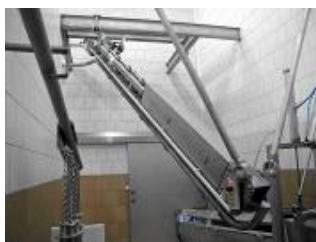
Монорельсовый транспортер пути обескровливания
